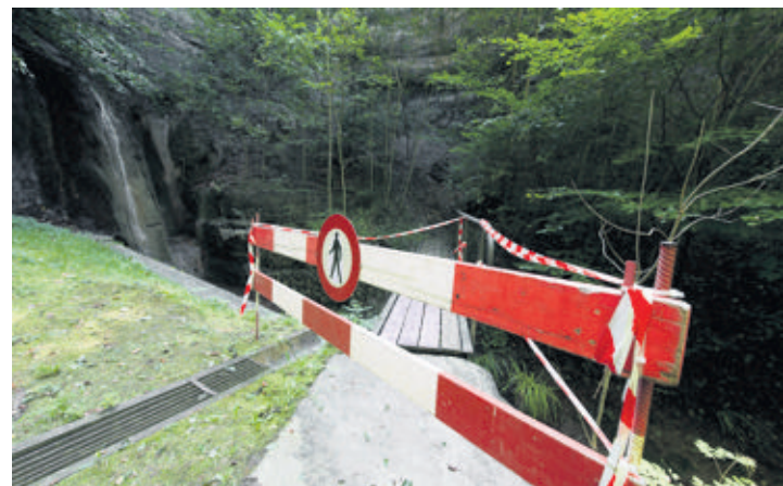
Le risque d'éboulement devenant trop important, la Municipalité de Payerne a décidé de fermer l'accès aux grottes. J.-P. GUINNARD
